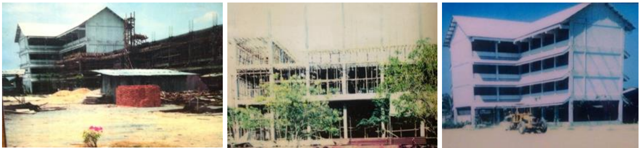
ภาพการก่อสร้างอาคารเรียนที่สองและสามของโรงเรียน
